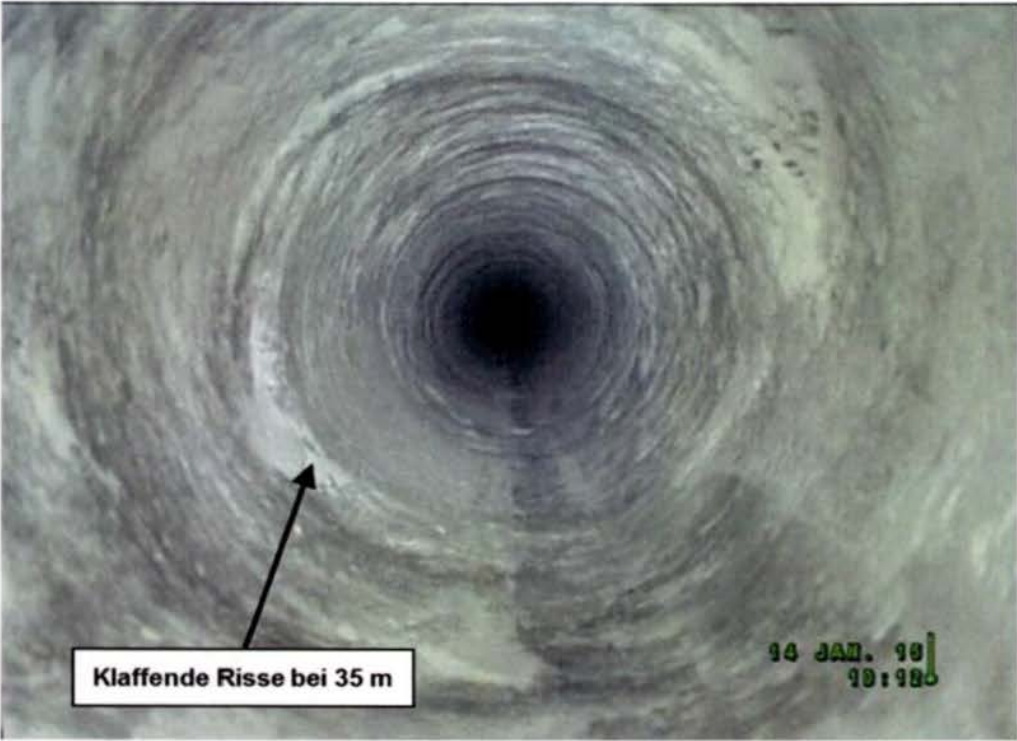
Abbildung 13: Foto aus der Kamerabefahrung: klaffende Risse bei Bohrlochteufe 35 m
