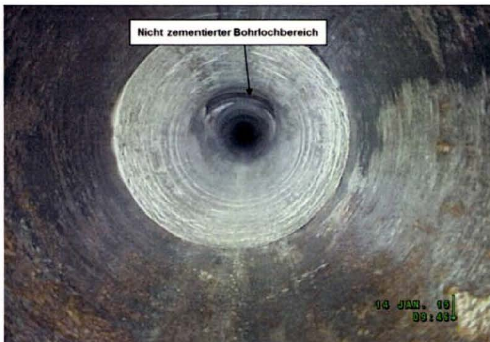
Abbildung 9: Nicht zementierter Bohrlochbereich bei Teufe von etwa 4 m
