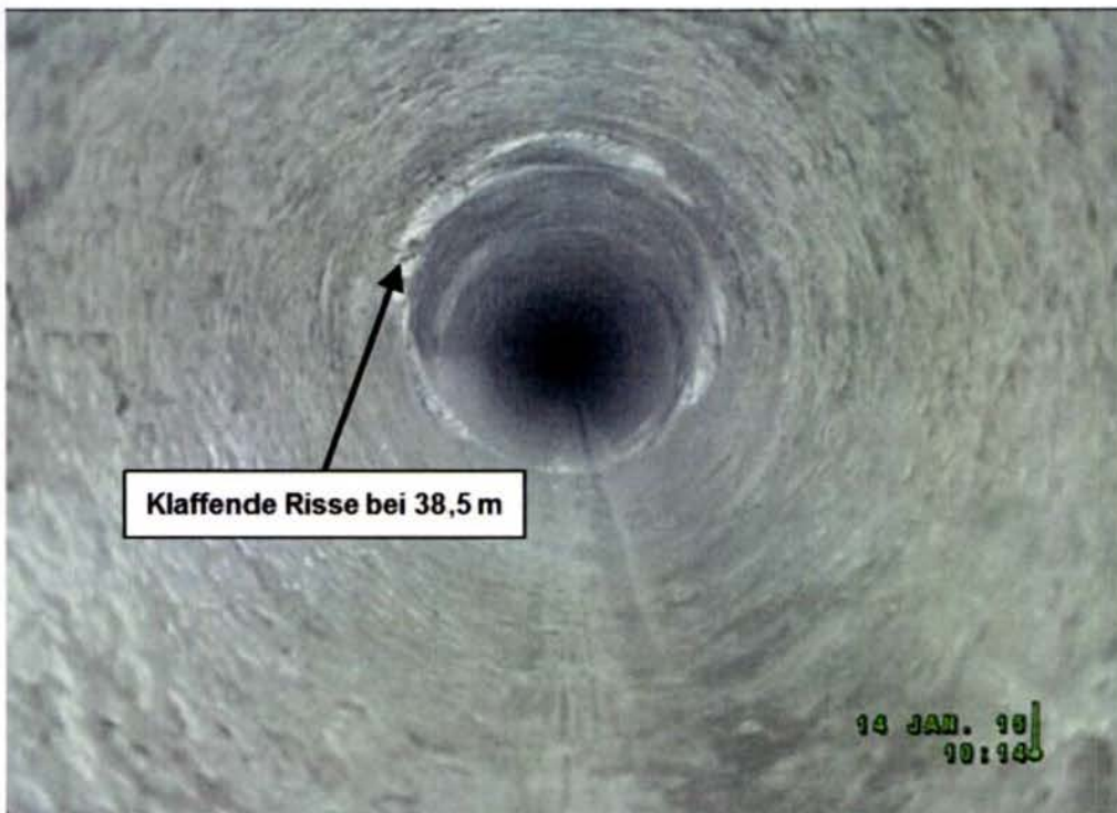
Abbildung 15: Foto aus der Kamerabefahrung: klaffende Risse bei Bohrlochteufe 38,5 m
